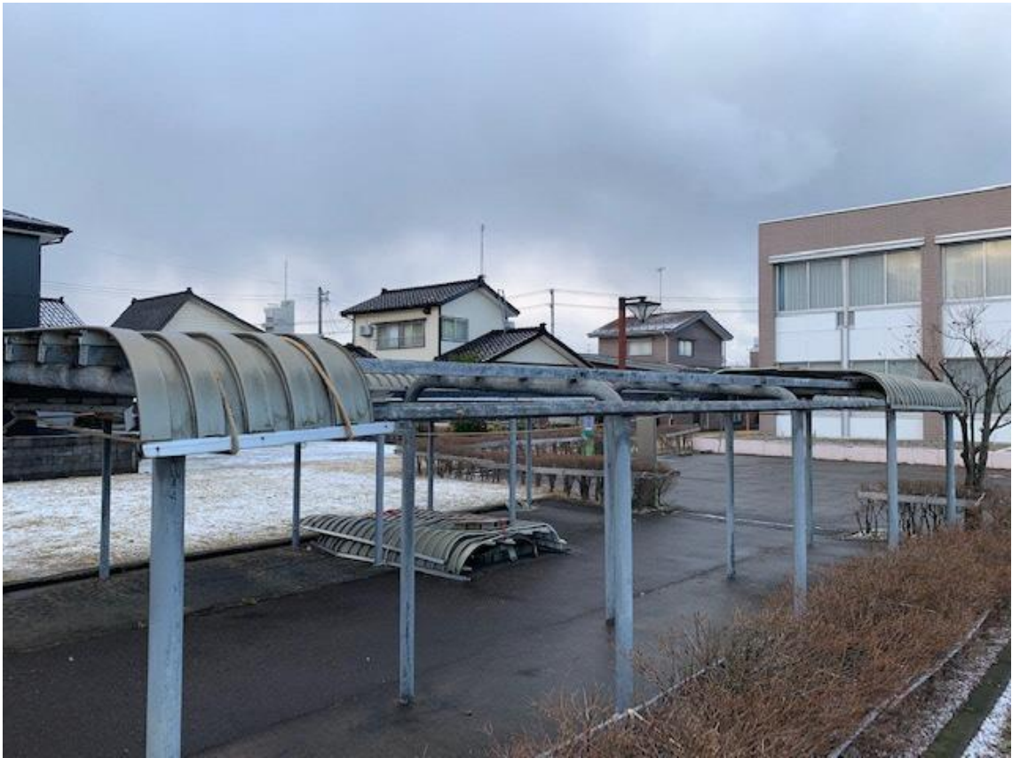
⑬強風により屋根が破損した公共施設の自転車置き場（田塚地内）
