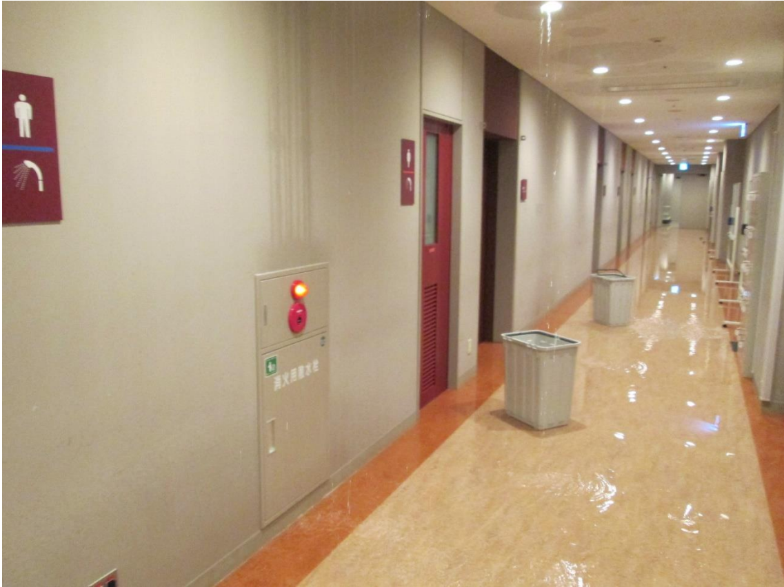
⑪ 漏水被害を受けた市立文化会館（日石町地内）
