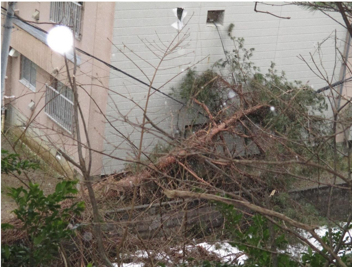
④ 倒木により、外壁が損傷した公営住宅（緑町地内）
