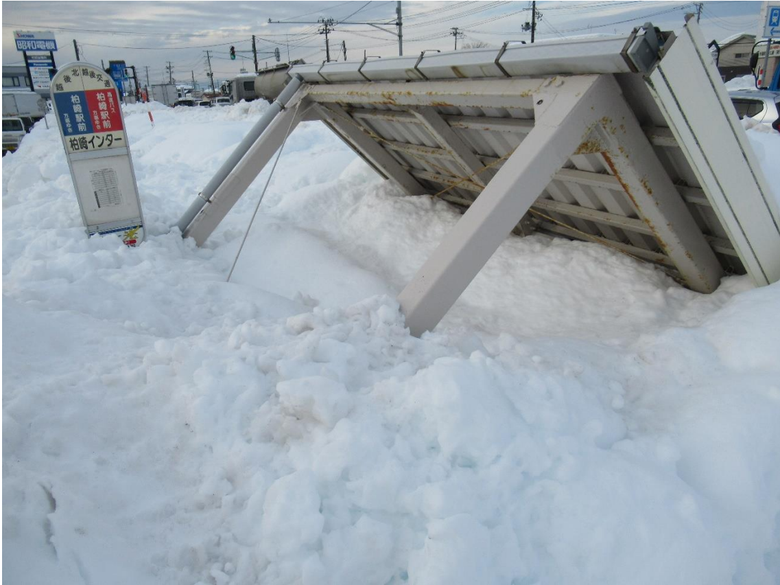
⑨ 大雪により倒壊したバス停建屋（茨目地内）
