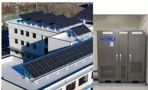
太陽光発電(出力約 65kW)、蓄電池(容量約 45kWh) 新校舎へ電力供給し脱炭素化を促進
