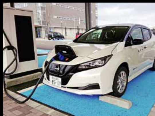
電気自動車用急速充電器 (市役所内)
