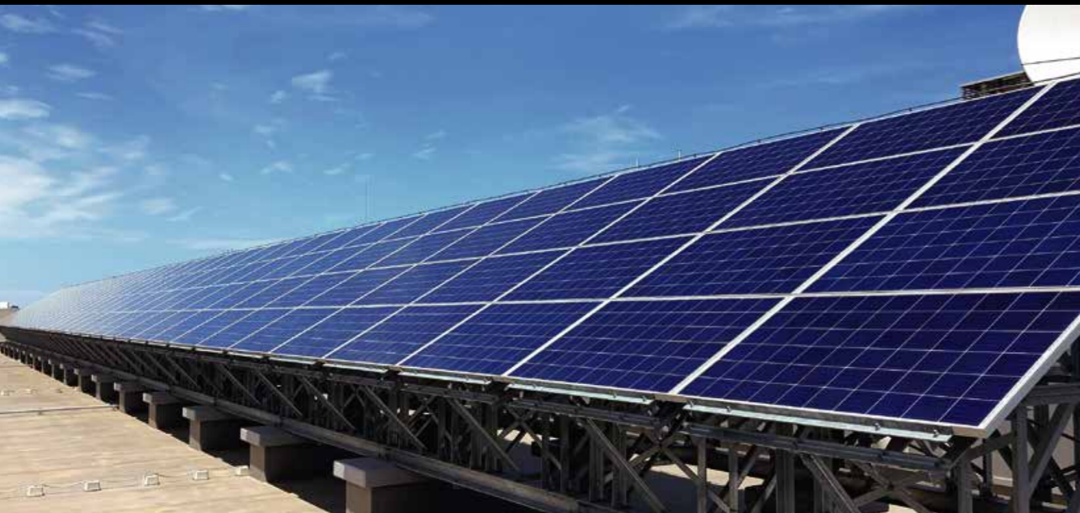
柏崎市役所屋上の太陽光発電設備
