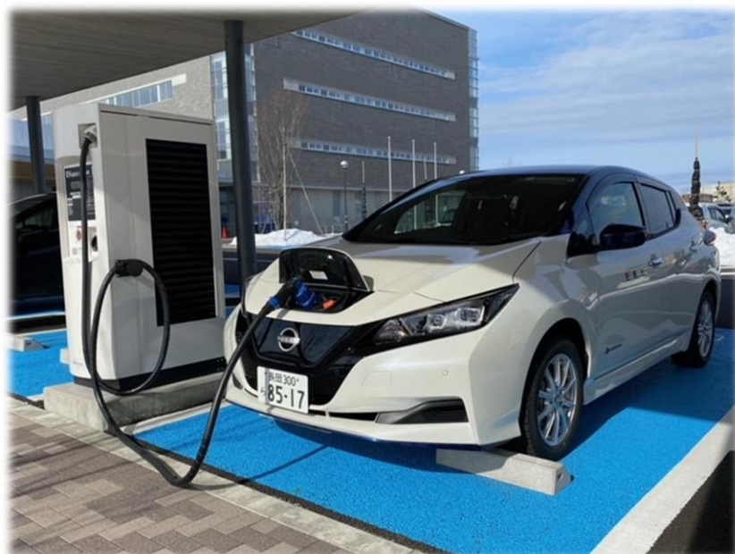
急速充電器 (市役所駐車場内)
