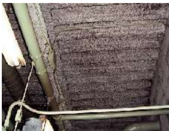
石綿含有吹付けロックウール
