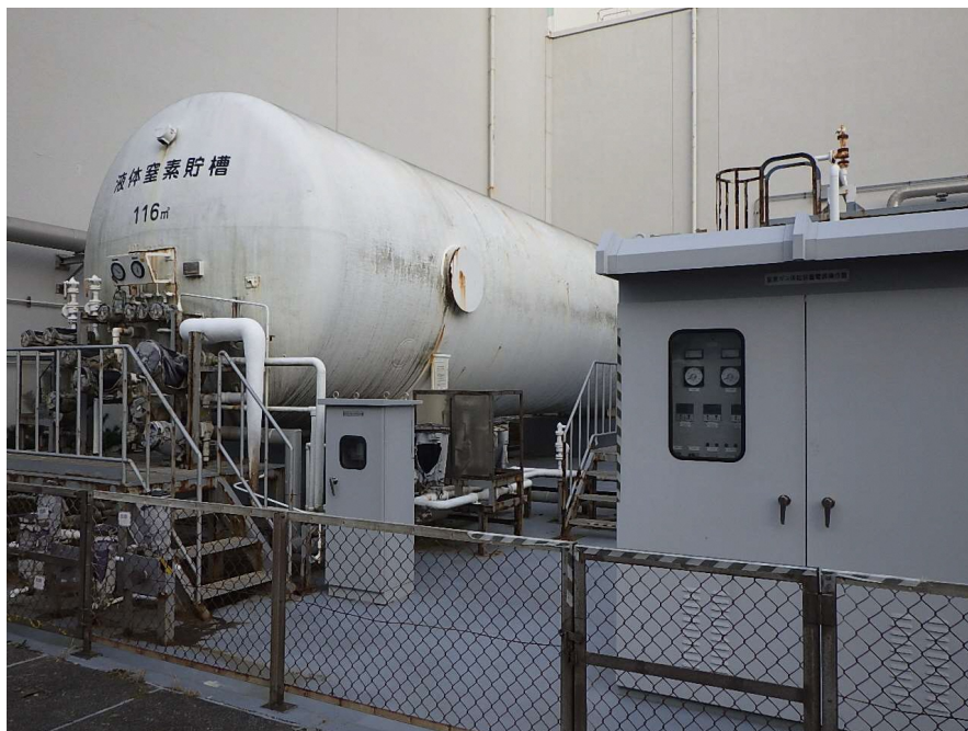
<格納容器内ガス濃度制御系>
