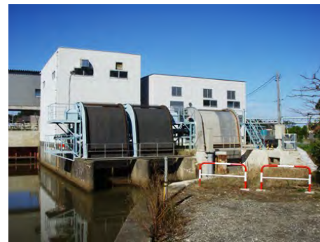
平成 21 年に増強された横山川排水機場
