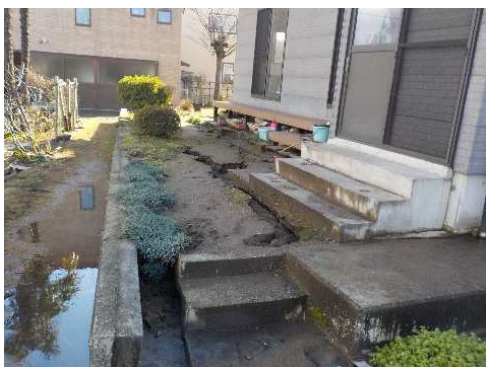
地盤の亀裂(柏崎市)
