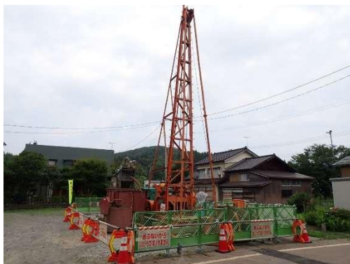
消雪パイプの更新 (井戸)
