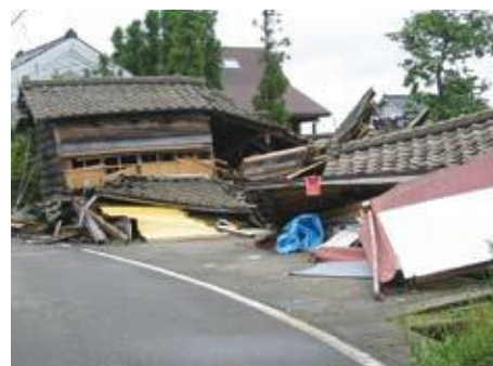
家屋被害の状況 (柏崎市内)
