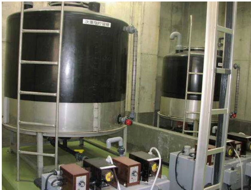
工業用水道 薬品注入ユニット
