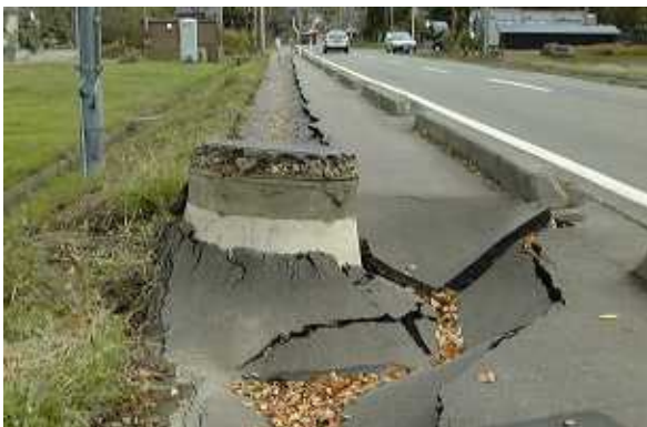
液状化によるマンホール浮上と道路陥没状況
