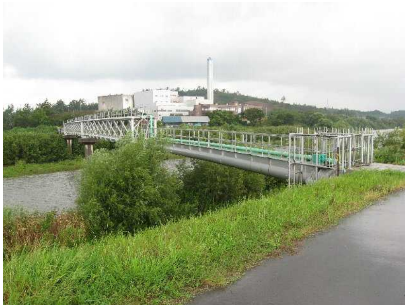
600 mm水管橋 六識橋
