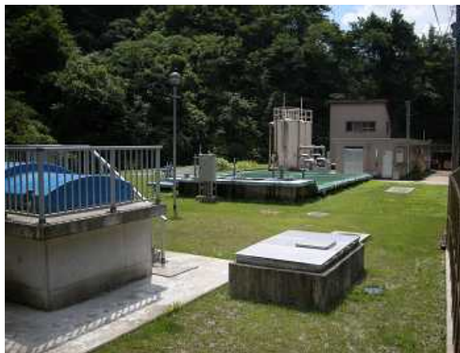
高柳町浄水場
