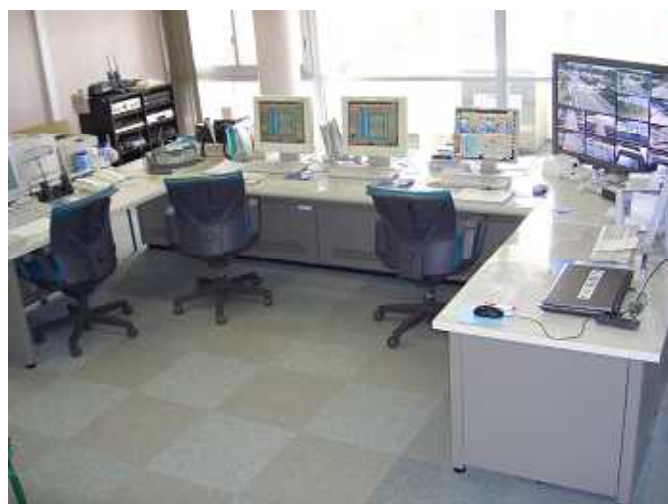
赤坂山浄水場 中央監視室
