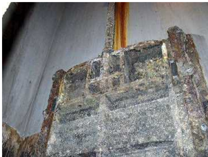
自然環境浄化センター 流入ゲート腐食状況
