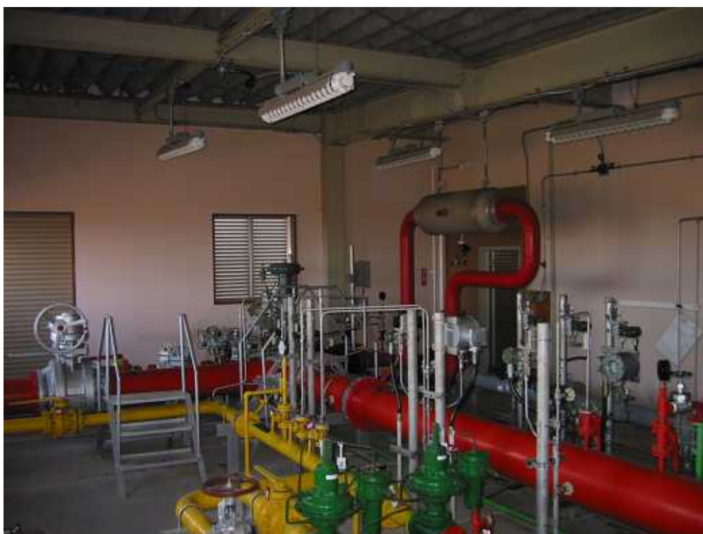
藤井供給所配管室
