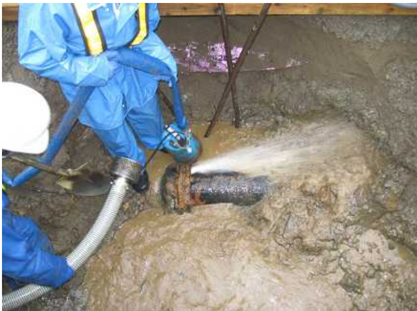
350mm 漏水現場（宝町地内）
