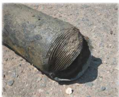
低圧ねじ管の被害状況
