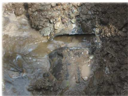
半田地内A中圧PLP300mmの被災状況
