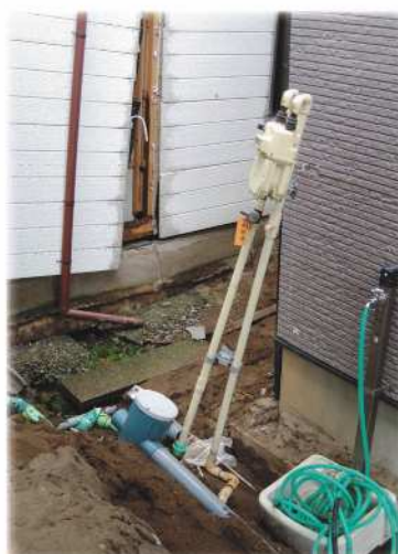
マイコンメーター周辺の被害状況
