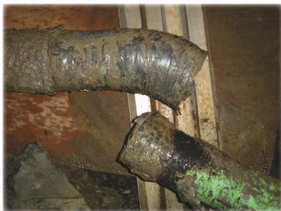
中圧導管の破断
