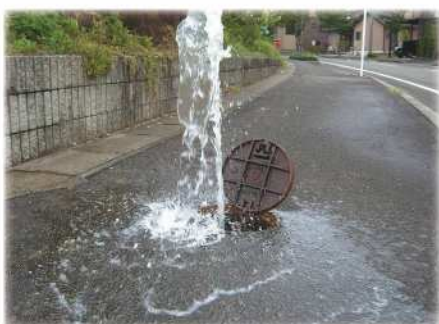
ガス管から水が吹き上げてきた
