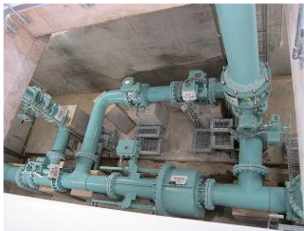
赤坂山発電所 配管設備
