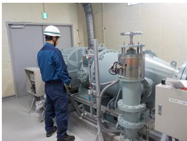
赤坂山発電所 発電設備
