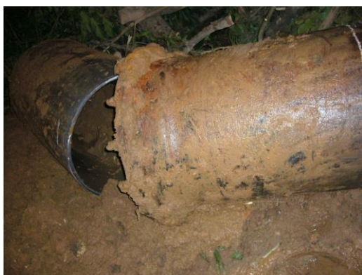
中越沖地震による 5 拡導水管（φ600 mm）の被災
