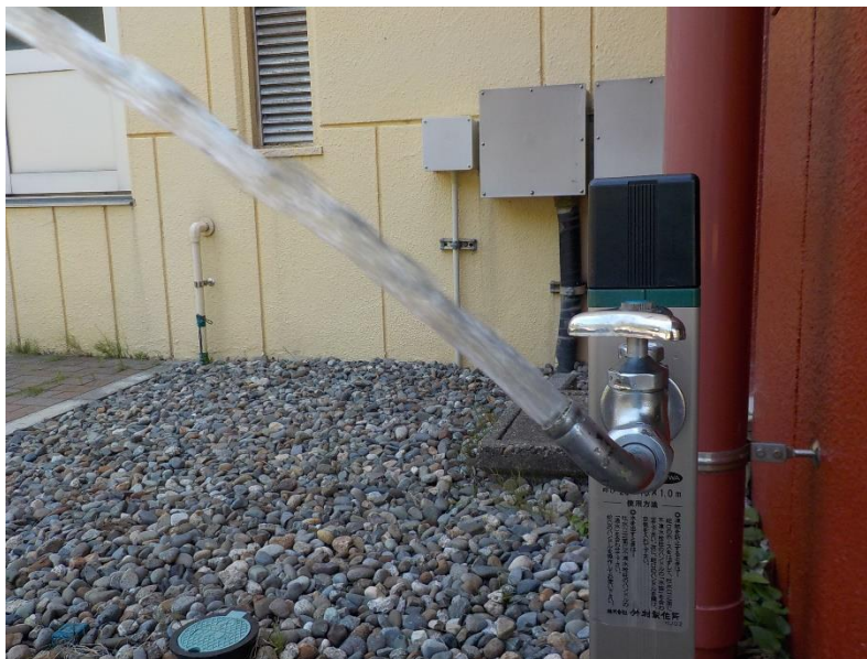
適正な水圧状況
