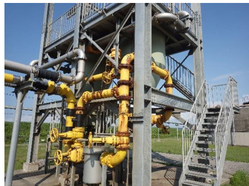
脱硫塔・配管
