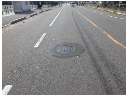
マンホール鉄蓋（更新後）
