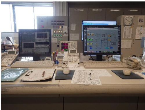
中央監視装置
