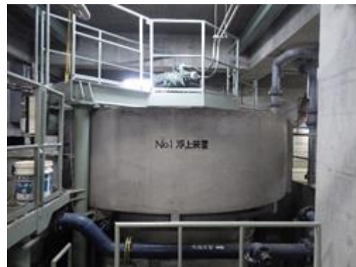
機械濃縮設備
