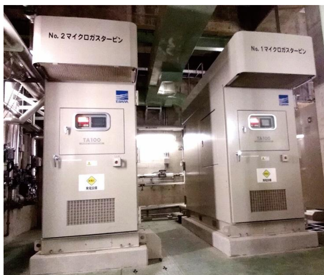
消化ガス発電設備
