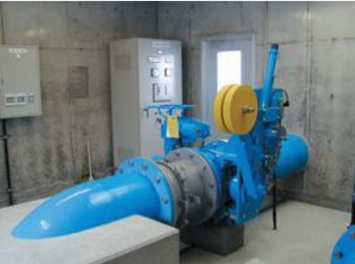
岬町配水場緊急遮断弁
