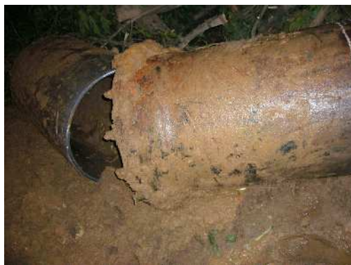
中越沖地震による 5 拡導水管（φ 600 mm）の被災
