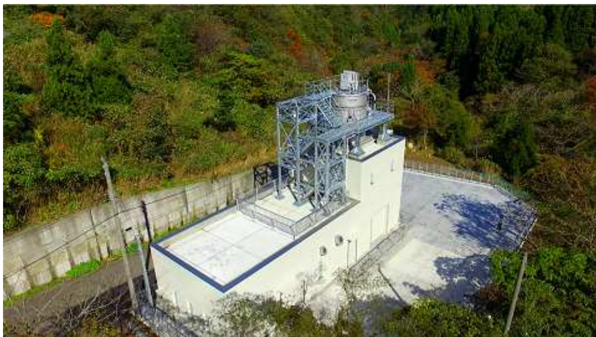
高度浄水処理施設
