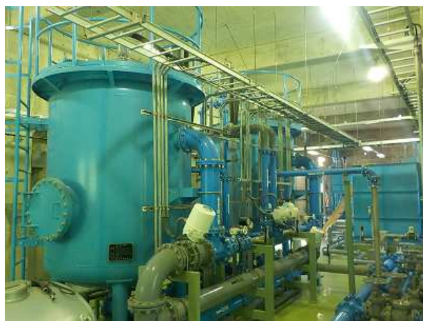
工業用水道 ろ過機設備
