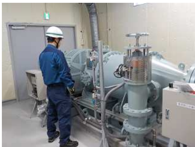
赤坂山発電所 発電設備
