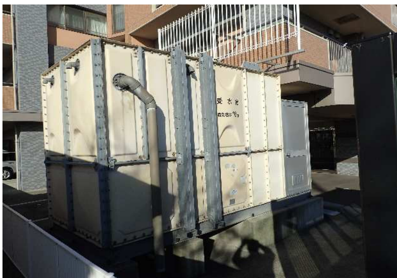
受水槽設備（10 m 3 ）
