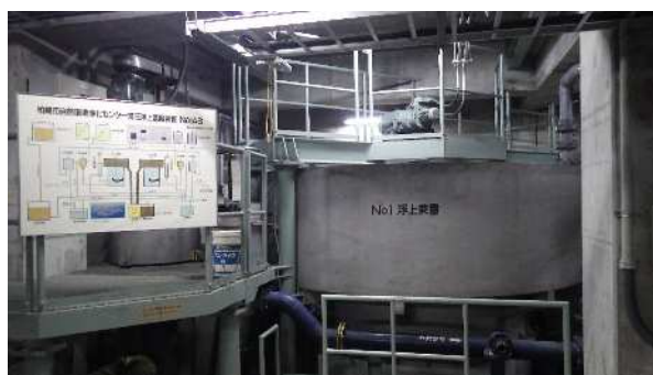
汚泥常圧浮上濃縮装置
