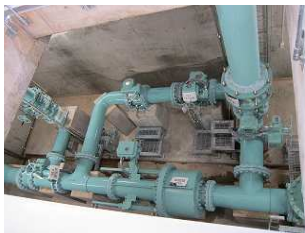
赤坂山発電所 配管設備
