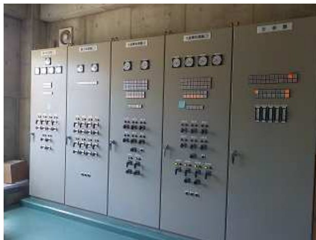
工業用水道 監視制御盤
