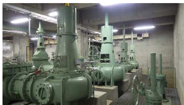
污水主ポンプ
