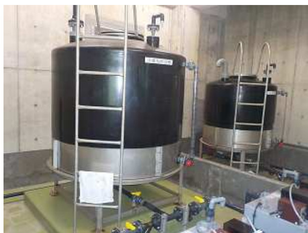
工業用水道 薬品注入ユニット
