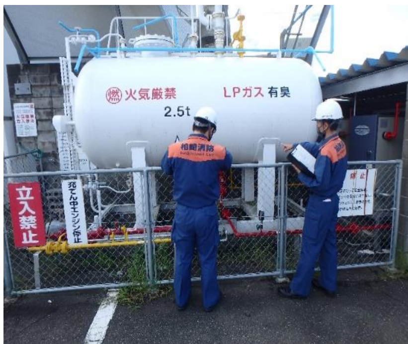
【液化石油ガス特定供給設備の立入検査】
