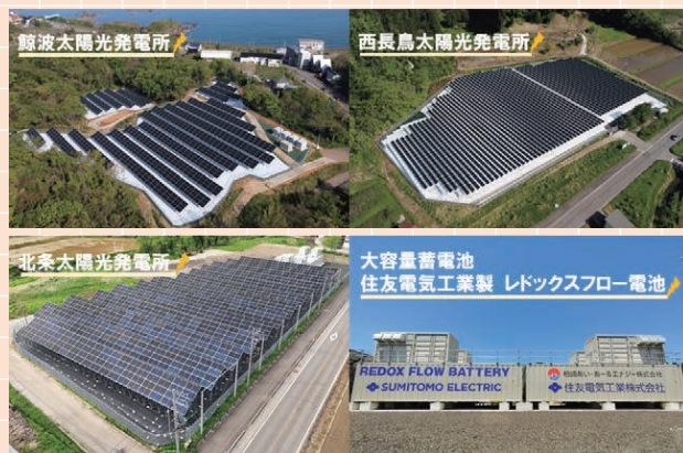
▲整備した太陽光発電設備と蓄電池設備
