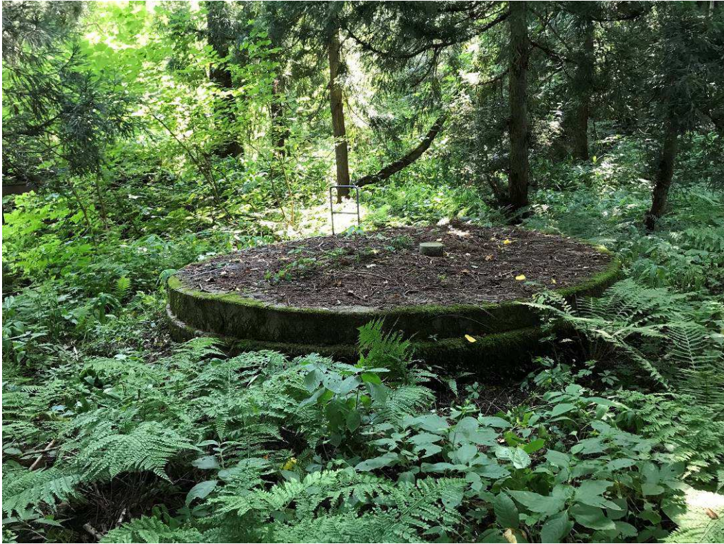
【栃ヶ原地すべり第三号集水井 全景（北側より） 新潟県撮影】
