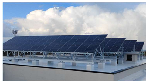
荒浜小学校PPA設備
