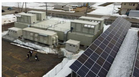
北条発電所（北条南小学校跡地）
