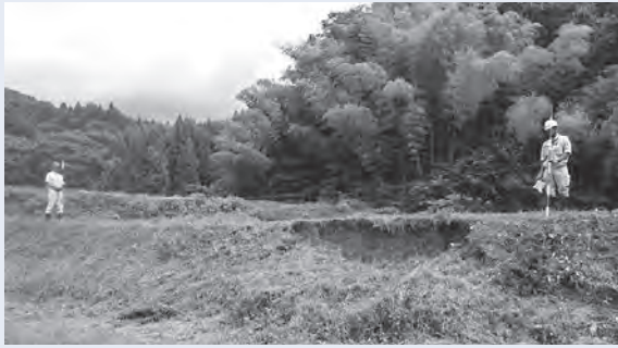
梅雨前線豪雨により崩落した農地(岩之入地区)
