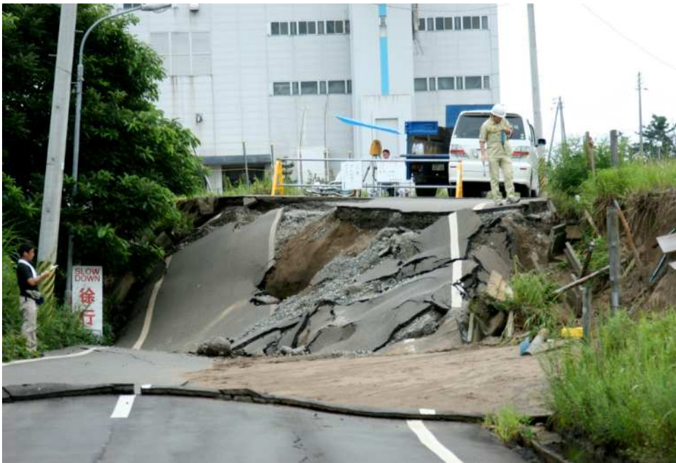
道路崩落(山本地内)
