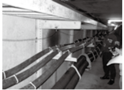
▲H30(2018)/11/1(木) 臨時状況確認 地下洞道内ケーブル火災の発生場所を確認
